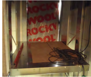
Risk att falla från insidan av korgen vid exponering för fallrisk.
