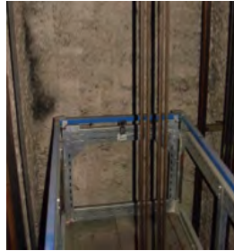
Asbest i schaktväggarna - iakta försiktighet vid misstanke om asbest.
