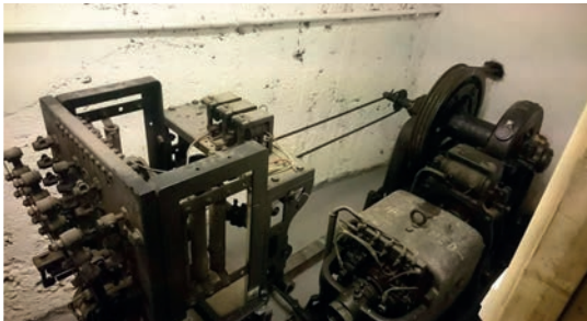
Stor risk för allvarlig elstöt vid oskyddad el och stor klämrisk vid roterande delar på äldre hissar.
